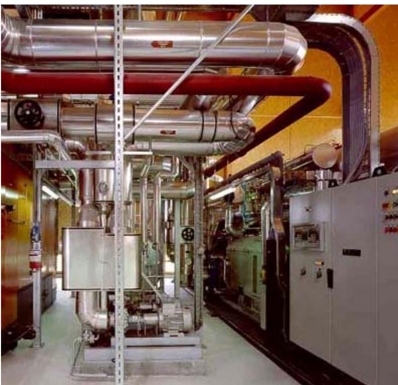
Fig. 5 Innenansicht der Heizzentrale Bière: Links die Holzfeuerung, in der Mitte die Pumpen zum Antrieb des Flüssigkeits-Kreislaufes, rechts die Turbinengruppe zur Stromerzeugung
